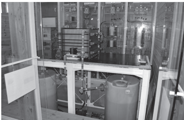
【図9】学内に設置されたレドックスフロー電池／下段2つの円形のタンクが「電解液タンク」
