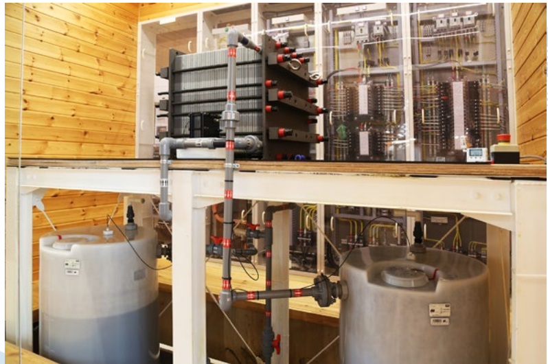
大学内に設置されたレドックスフロー電池。上が電池本体、下が電解液タンク
